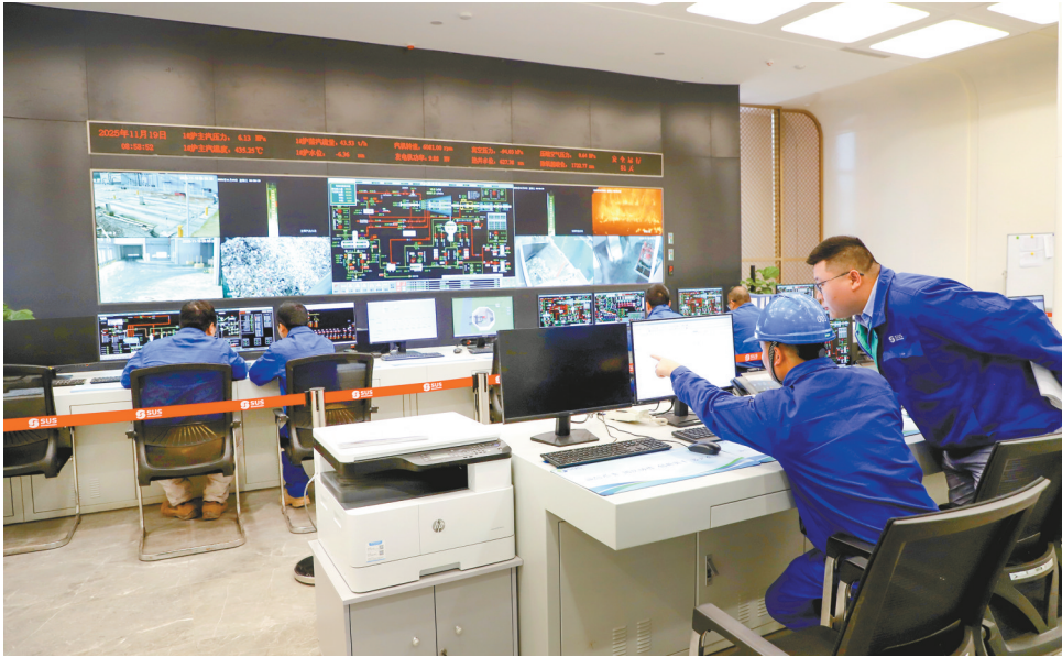
工作人员正在查看垃圾焚烧发电运行状态。
