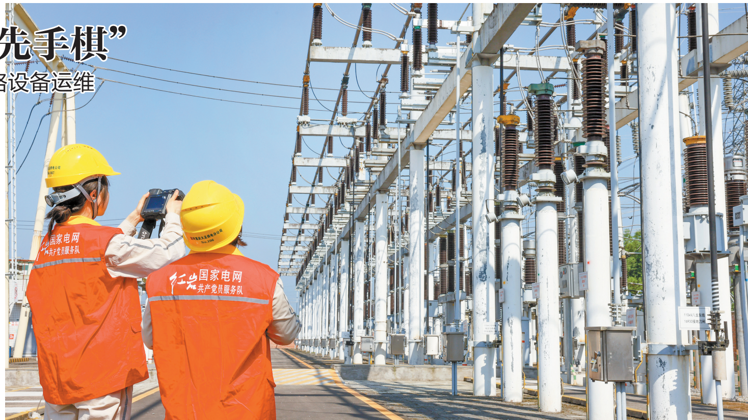
国网大足供电公司员工在220千伏八柱变电站开展红外测温工作。
