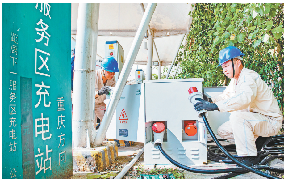
在北碚区的渝广高速静观服务区充电站,检修人员对移动式充电桩的智能插座进行日常检修。 重庆日报记者 张锦辉 摄
