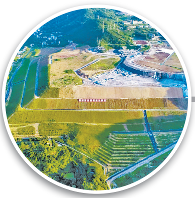
治理中的磷石膏堆场。(资料图)
