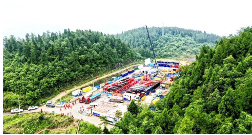
涪陵页岩气田焦页2HF井重复压裂施工平台。涪陵页岩气公司供图
